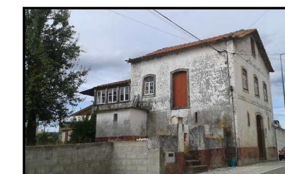
Mau Estado de Conservação
