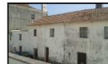
Mau Estado de Conservação
