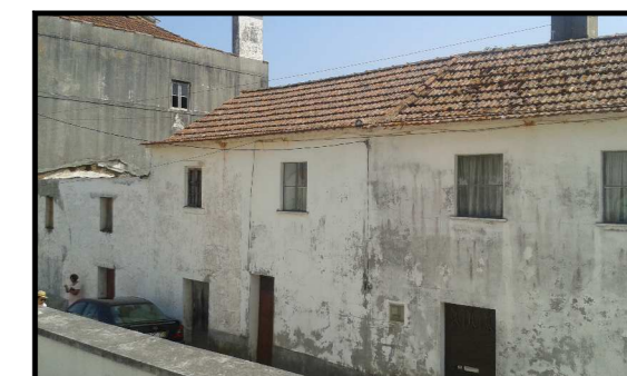
Mau Estado de Conservação
