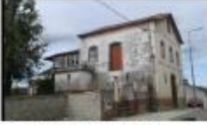
Mau Estado de Conservação
